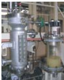
パイロットプラント
