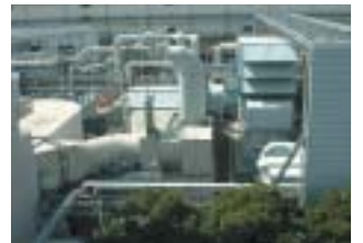
横浜磯子事業場 第2コージェネレーションシステム
