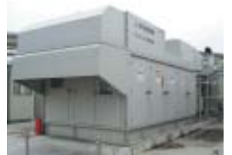
堺事業場 コージェネレーション設備
