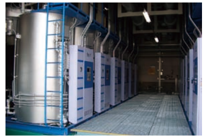
貫流ボイラ（横浜磯子事業場）
