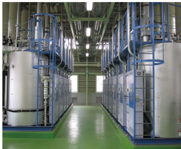
貫流ボイラ(水島工場)
