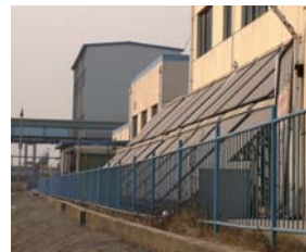
太陽熱利用給湯設備
