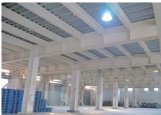
工場内に設置したLED照明
