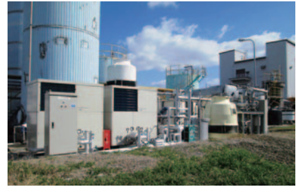
ガスコジェネレーションシステム外観
