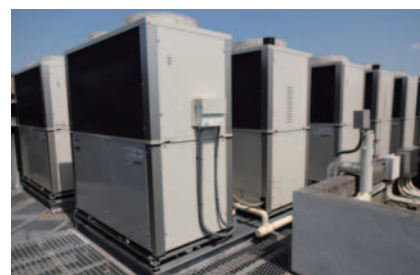
横浜磯子事業場に導入したガスヒートポンプ
