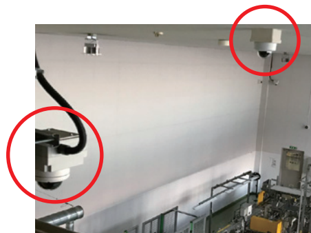
工場内に設置している記録カメラ
