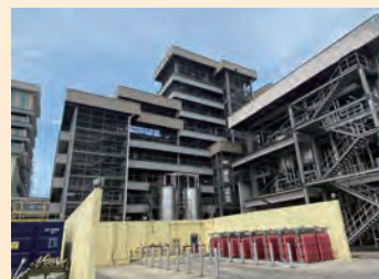
増強した酵素エステル交換設備
