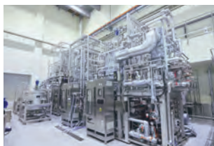
パイロット設備の一部
