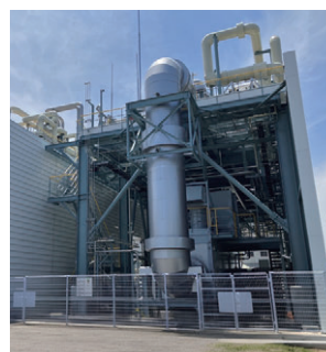
横浜磯子事業場で稼働開始した水素混焼対応型コージェネレーションシステム
