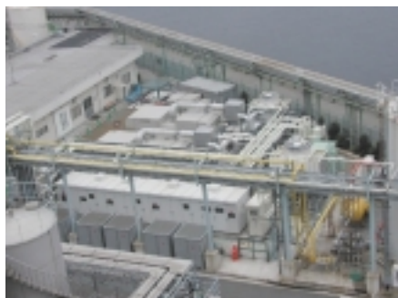
ガスエンジンコージェネレーション( 堺事業場 )
