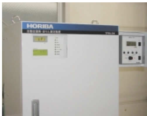
窒素・リン連続監視装置( 堺事業場 )
