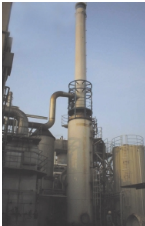
排煙脱硫装置( 名古屋工場 )
