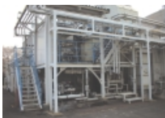
ボイラーおよび脱硫装置( 名古屋工場 )
