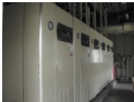
小型ボイラー( 堺事業場 )
