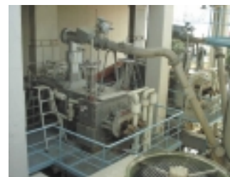
脱リン污泥乾燥機(横浜磯子事業場)
