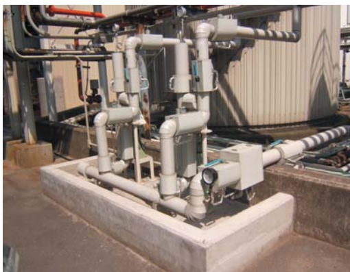
植物性廃油混焼設備
