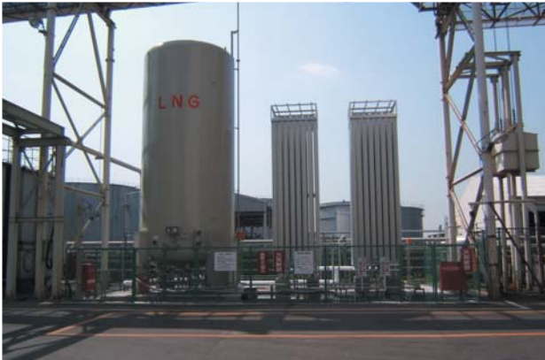
LNG燃料設備
