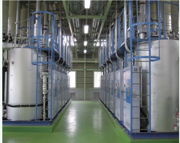
貫流ボイラ(小型ボイラを12基設置)
