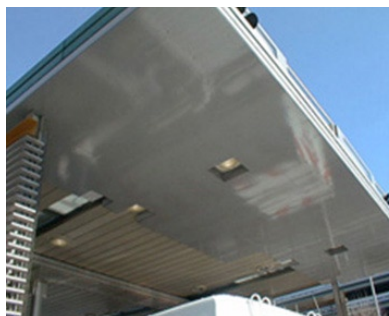
料金所の天井等に電波吸収体を使っています。
