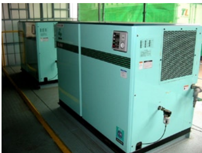
オンオフ式からインバーター式のコンプレッサーに更新し、約10%のエネルギー削減しました。
