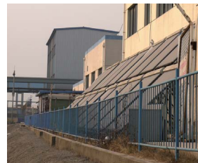
太陽熱利用給湯設備
