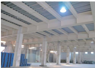
工場内に設置したLED照明
