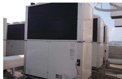
ガスヒートポンプ式のエアコン
