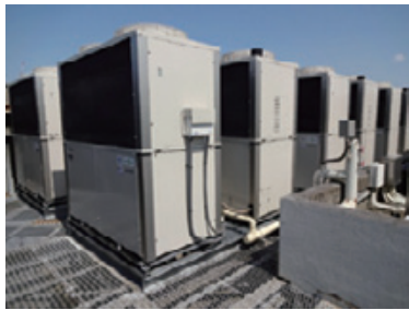
横浜磯子事業場に導入したガスヒートポンプ
