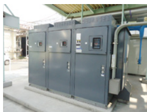
水島工場に導入した脱臭用冷凍機
